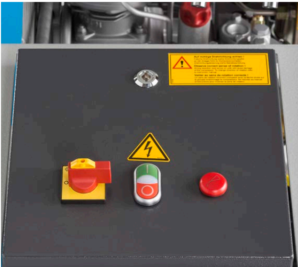
Система управления компрессором MARINER, с главным выключателем, выключателем и сигнальной лампой для контроля за уровнем масла / направлением вращения
